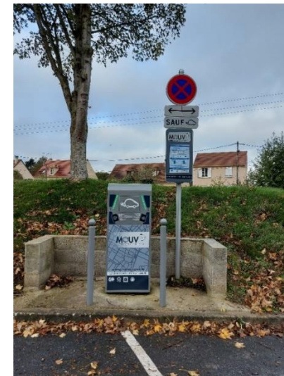
Figure 33 – Borne de recharge électrique à Ivry-le-temple (source : Ingetec)
